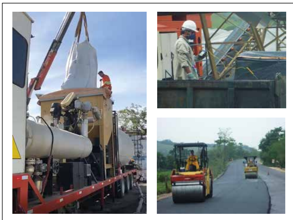
Figura 2.48 – Exemplo de usina móvel de preparação de asfalto-borracha na usina atuando numa obra do estado do Rio de Janeiro
