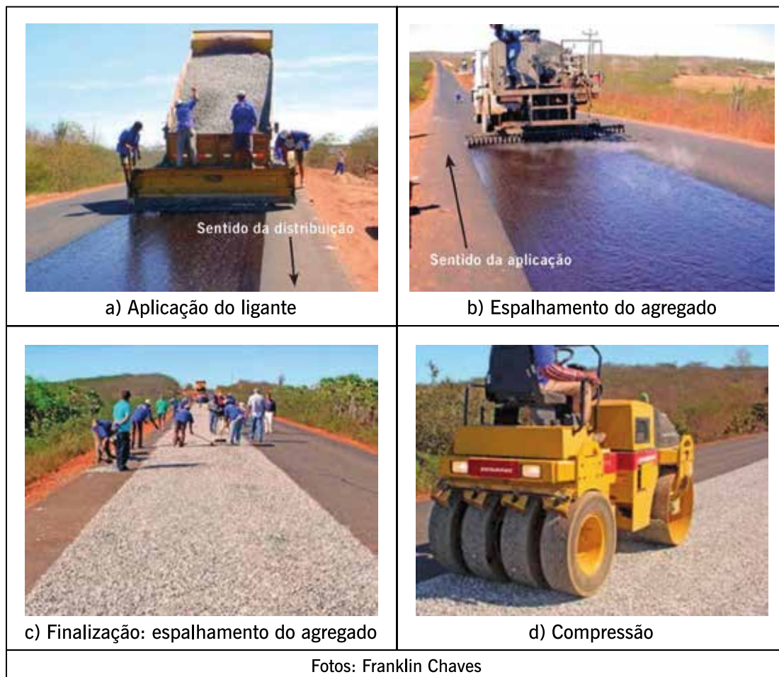
Figura 8.38 – Exemplo das etapas de construção de um tratamento superficial (fotos: Franklin Chaves)
