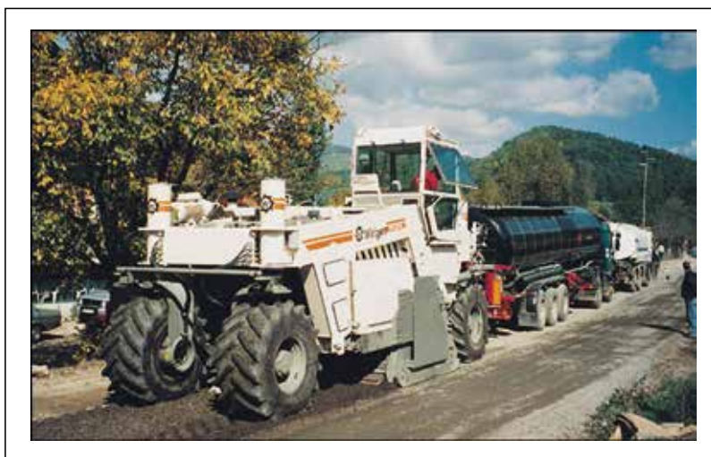
Figura 8.35 – Exemplo de trem de reciclagem com asfalto espuma ou emulsão asfáltica executada em pista
