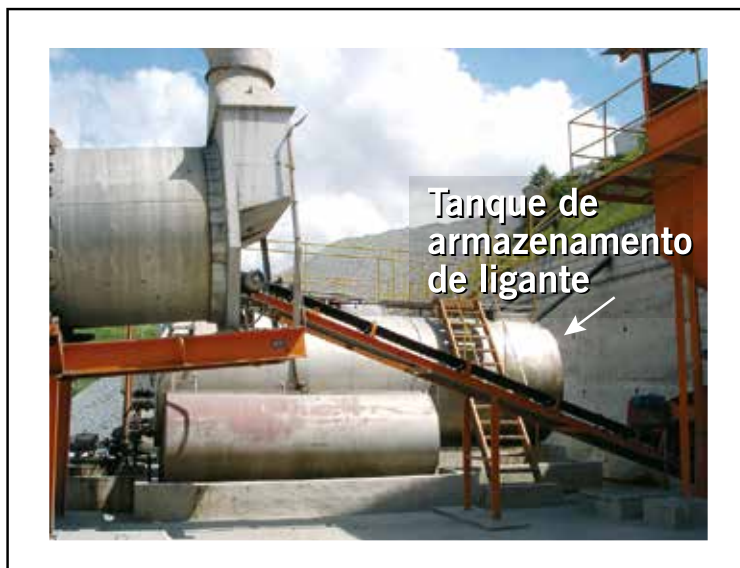
Figura 8.6 – Exemplo de tanques horizontais para armazenamento com aquecimento de ligantes asfálticos de uma usina gravimétrica
